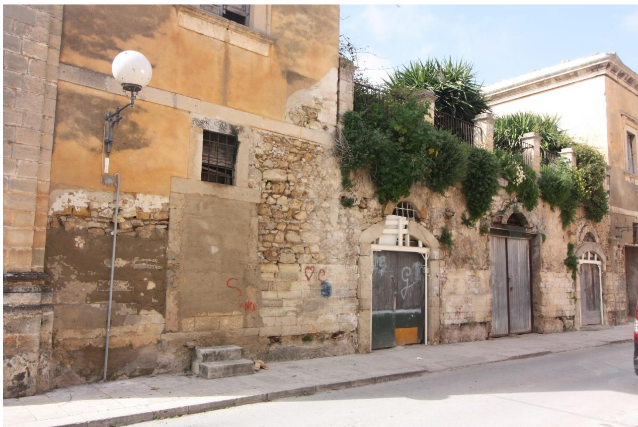
Figura 4 – Stato conservativo delle murature su Via Carlo Alberto
