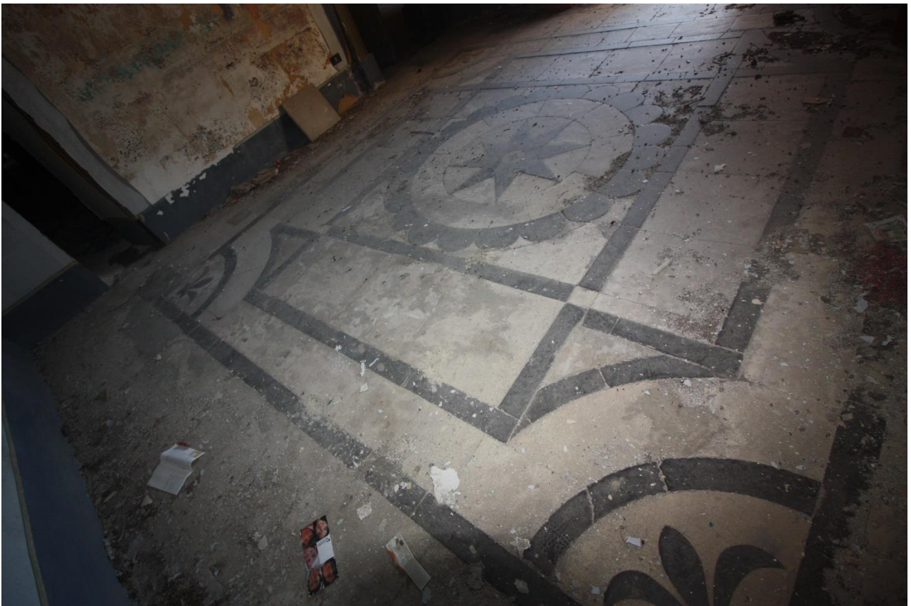
Figura 43 – Camera da letto, scorcio della pavimentazione originaria in calcare duro e pietra pece
