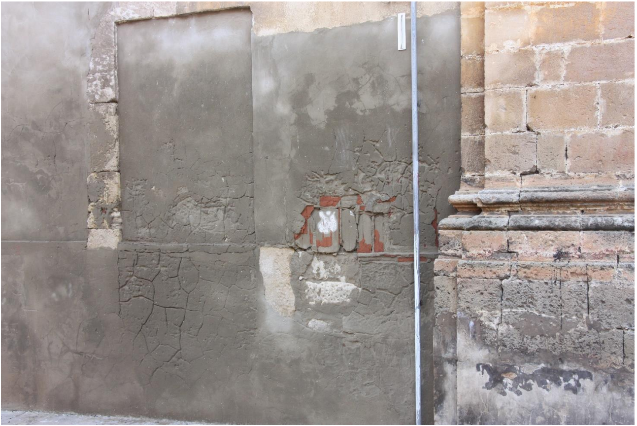
Figura 6 - Superfetazioni sul prospetto di Via Marsala
