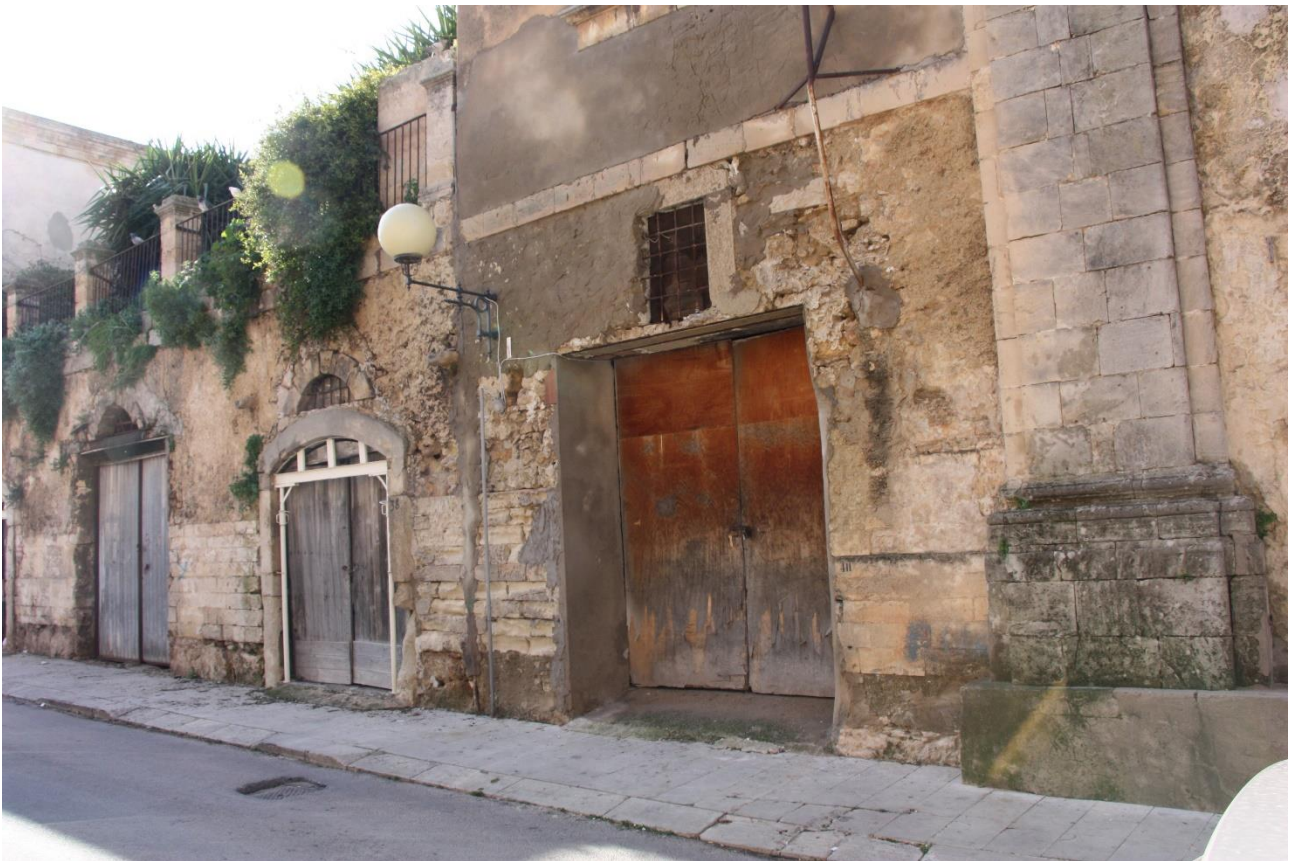
Figura 7 - Superfetazioni e degrado delle superfici su Via Carlo Alberto
