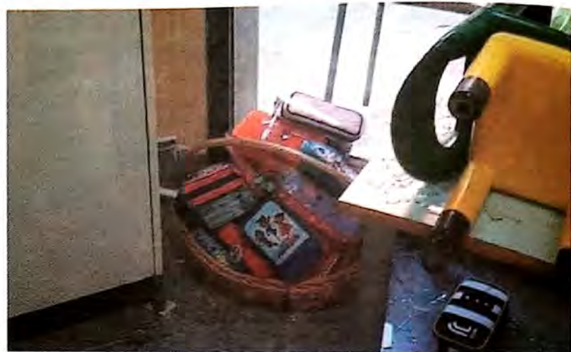
I danni causati dai vandali alla scuola dell'infanzia
