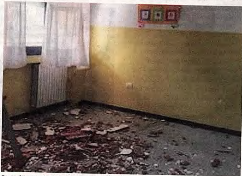
Scuola. L'aula interessata al crollo degli intonaci (*FOTO FC*)
