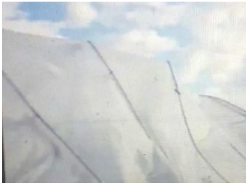
ALCUNE IMMAGINI DEI DANNI CAUSATI DALLA TROMBA D'ARIA
