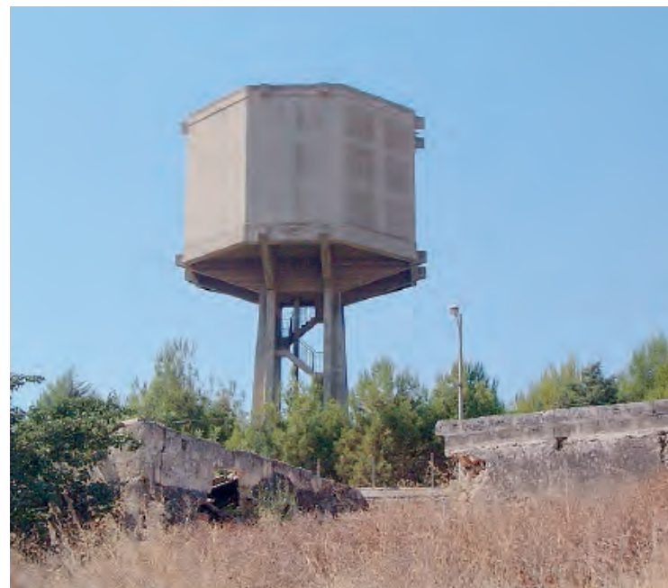
Uno dei serbatoi che forniscono acqua alla città e che risulta fare i conti con tutta una serie di disagi penalizzanti per la collettività
