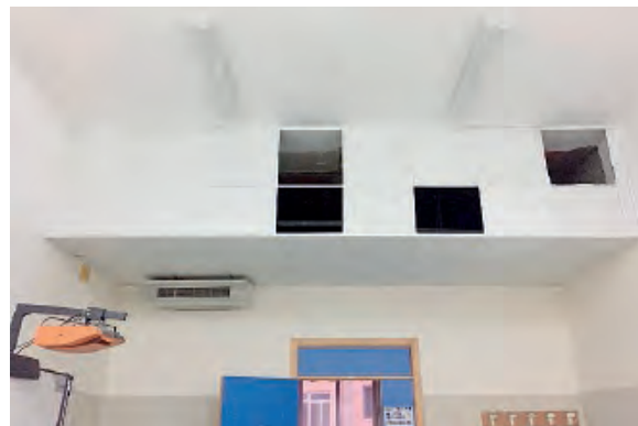
Le condizioni dell'istituto Mazzini (sopra e in alto a sinistra) e l'estintore senza manutenzione
