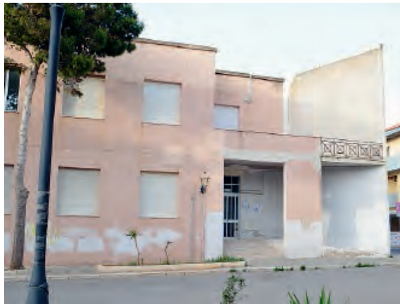
Gli edifici scolastici di Scoglitti saranno adeguate alle norme antincendio. Nella foto la scuola Sciascia
