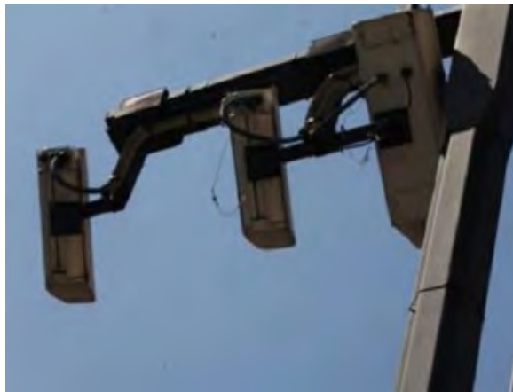
Le telecamere che saranno installate nel centro urbano della città e nella frazione di Scoglitti.
