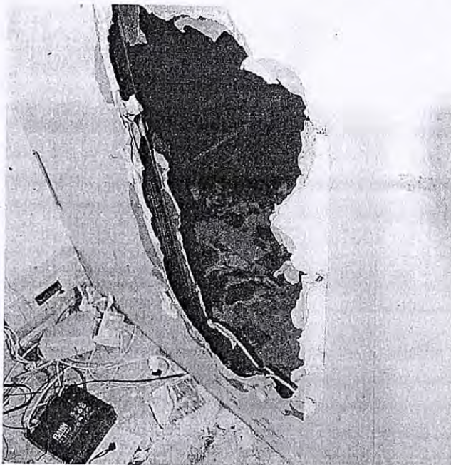
Il buco realizzato in una parete di cartongesso del supermercato
