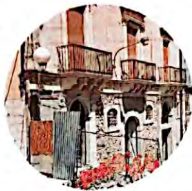
Lavori in corso. L'edificio di fine Settecento acquistato dall'artista per diventare spazio museale.
