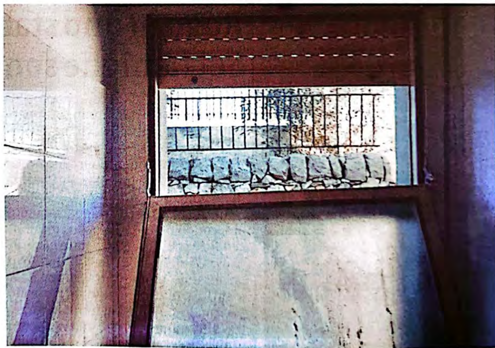
Le finestre forzate prese di mira dai vandali
